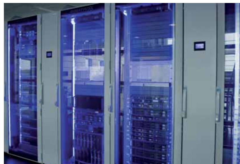
Het RimatriX5 systeem van Waterschap Hunze & Aa's, met geïntegreerde LCP rack-koeling, UPS-koeling, intern blussysteem en CMC-bewakingsmodule.
